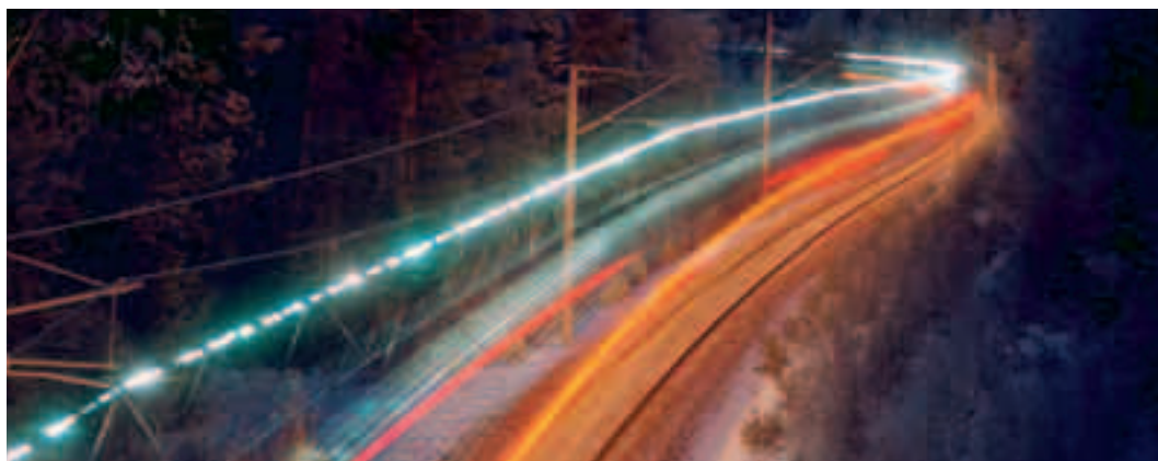
Kontaktledningen projekteras med avancerade dataprogram för att samspelet med tågets strömavtagare ska bli optimalt. Här ses gnistor från strömavtagare på ett passerande tåg.
